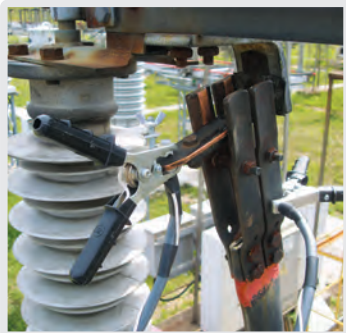
Измерение переходного сопротивления контактных соединений заземляющего разъединителя.
