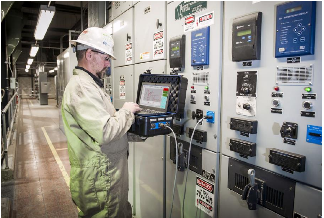
Техник работает с анализатором EXP4000, подключенным к порту блока связи EP1000 на щите управления МСС.
